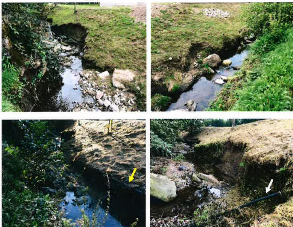
Figura 3 – Incisione del fondo e erosione del piede in sponda destra: sopra 30.06.2017, sotto 26.09.2018. La freccia in giallo evidenzia il mancato attecchimento di una fascinata viva di salice; la freccia in bianco evidenzia invece la condotta AP scalzata.
